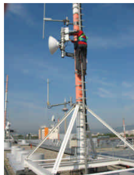
CBL-Techniker bei der Ausrichtung der Antenne
