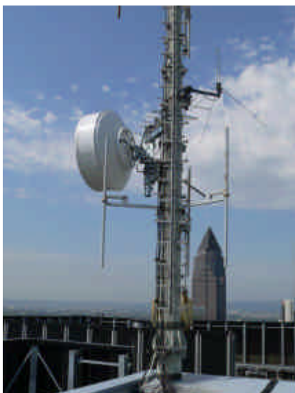
Installierte 60 cm Antenne am Umlenkstandort
